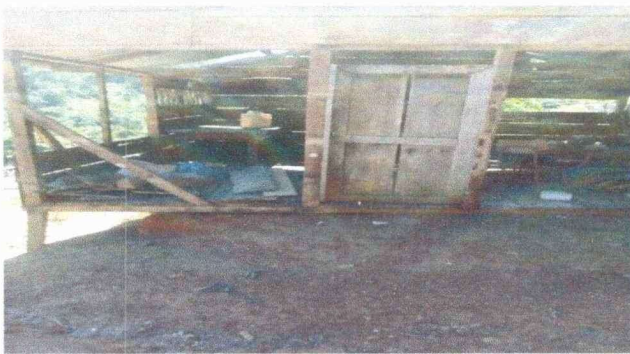
Foto 3. Necesidad de cambio de techo.
